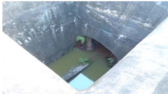
น้ำรั่วเข้าบริเวณท่อตั้ง
