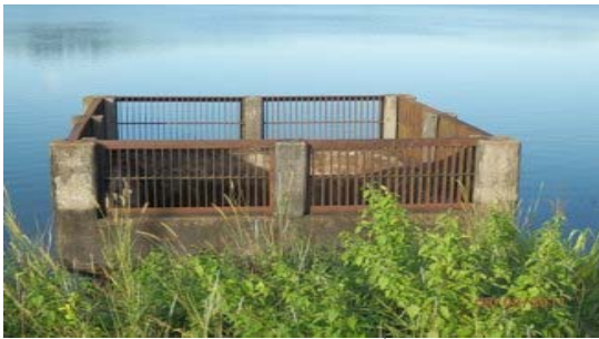
ส่วนควบคุมน้ำ
