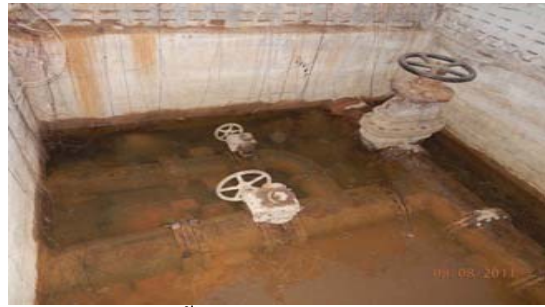
น้ำขังภายในอาคาร
