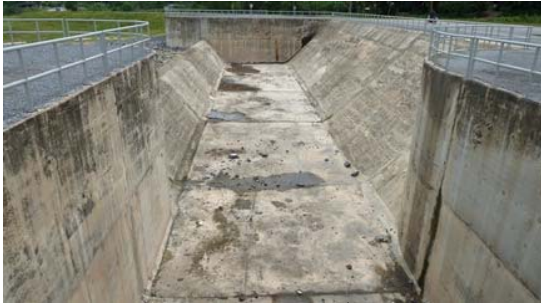
ส่วนควบคุมน้ำ
