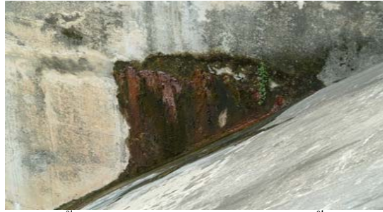
น้ำรั่วบริเวณกำแพงส่วนควบคุมน้ำ
