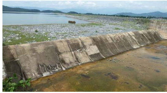
รอยรั่วที่ฝายคอนกรีต
