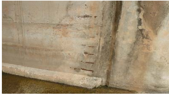
สภาพตอม่อสะพานรถยนต์
