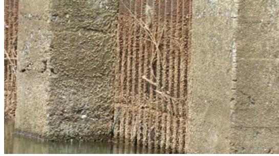
ผิวคอนกรีตถูกกัดกร่อน
