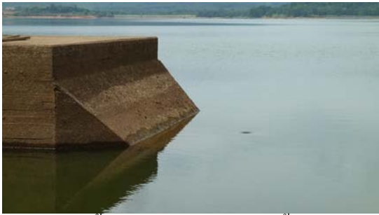
นํ้าวนด้านท้ายอาคารรับน้ำ
