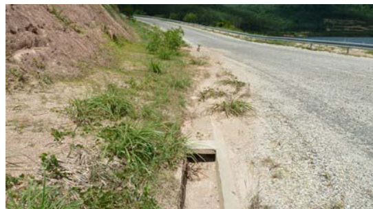
รางระบายน้ำมีดินที่ถูกกัดเซาะ
