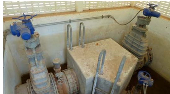
อุปกรณ์ควบคุมบนระบายน้ำ
