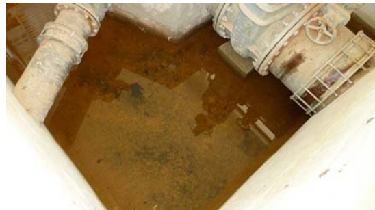
น้ำขังภายในอาคาร
