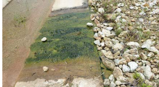
น้ำซึมเหนือรางระบายน้ำ
