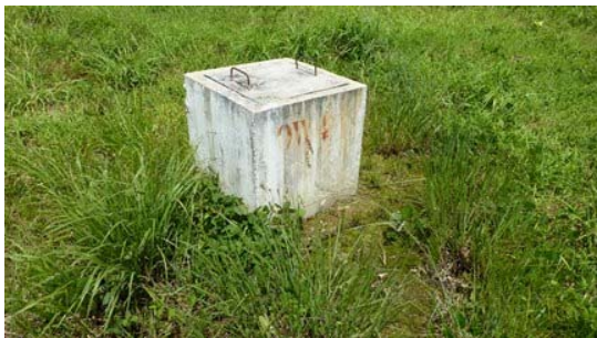
บ่อสังเกตน้ำใต้ดิน
