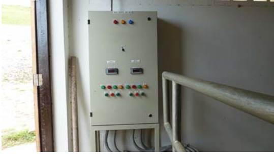
อุปกรณ์ไฟฟ้ายังไม่มีเชื่อมต่อกับภายนอก
