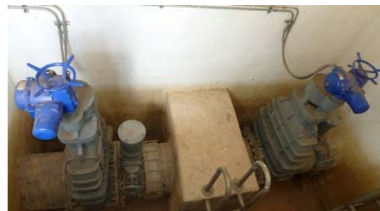
อุปกรณ์ควบคุมบานระบายน้ำ
